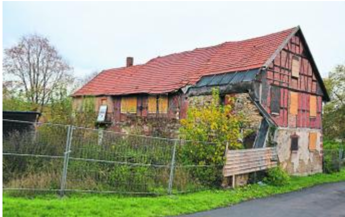
Im Rahmen der Dorfentwicklung soll das Ruinengrundstück in Roß- bach geräumt werden.
